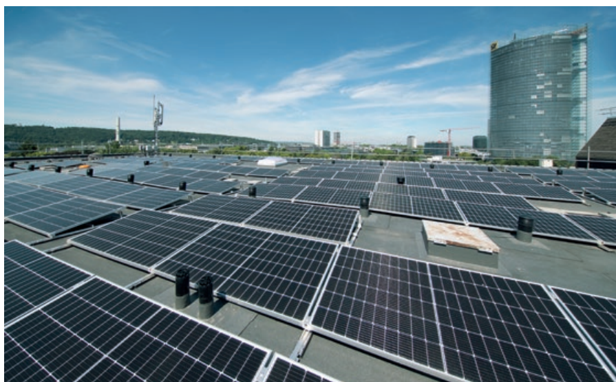
Solaranlage auf dem Dach des Johanniter-Krankenhauses in Bonn (Foto: Johanniter)
